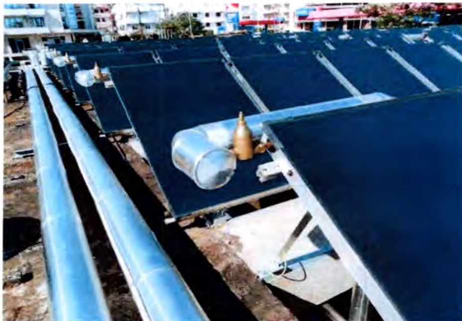
Solarni paneli u TN Slovenska plaža
